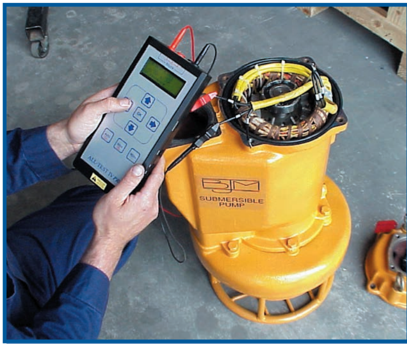
Probando el estado eléctrico de una combinación motor/bomba, le permite tomar una mejor decisión de reparación ó remplazo.
